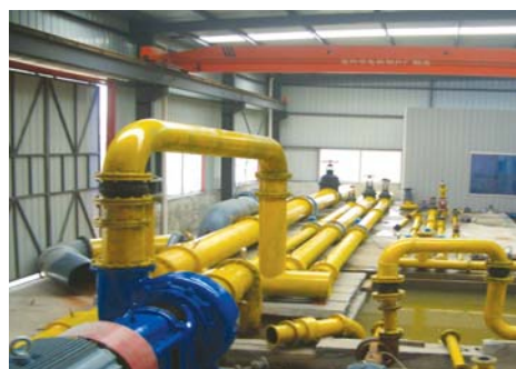
▲ 喷嘴测试泵站
